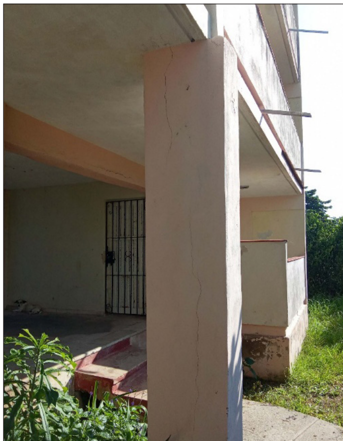
Figura 8. Detalle de la construcción de una columna de reforzamiento (apuntalamiento) en el Edificio No. 330 del Reparto Camilo Cienfuegos, municipio Habana del Este, afectado por carso subterráneo, tras el desarrollo expansivo de una cueva abierta en su vecindad (Cueva de los Camarones). Fuente: Instituto de Geofísica y Astronomía, 2024.
