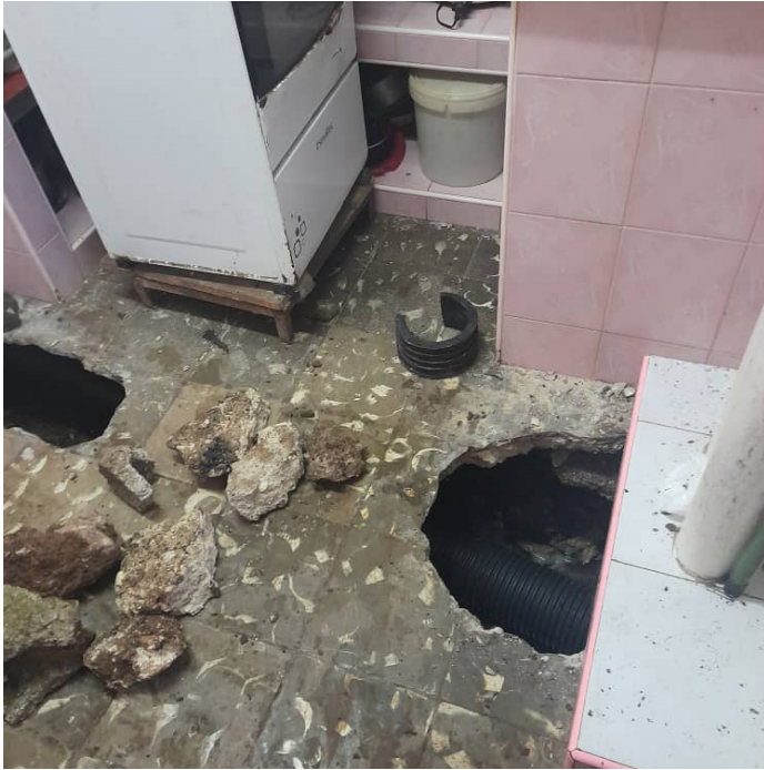
Figura 9. Hundimiento en el piso de la cocina en la planta baja del apartamento 12, edificio A-46, Zona 23, Alamar, municipio Habana del Este, presumiblemente originado por erosión sufosivo – cársica (succión cársica), con la consiguiente pérdida del relleno y sostén bajo el mosaico. Fuente: original de los autores, 2024.
