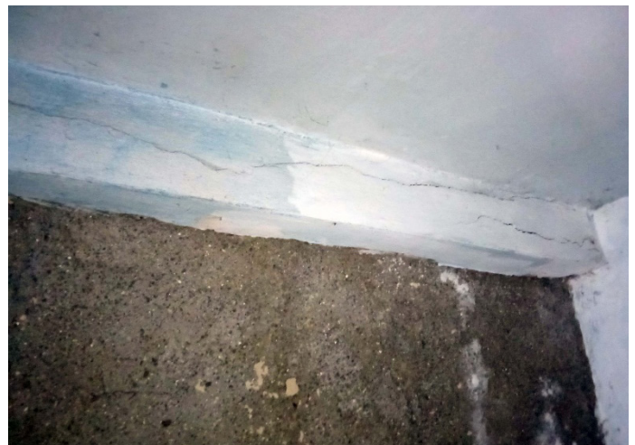
Figura 11. Rajaduras en el arquitrabe de vivienda en San Lázaro 655, e/ Gervasio y Padre Varela, municipio Centro Habana. Fuente: original de los autores, 2024.
