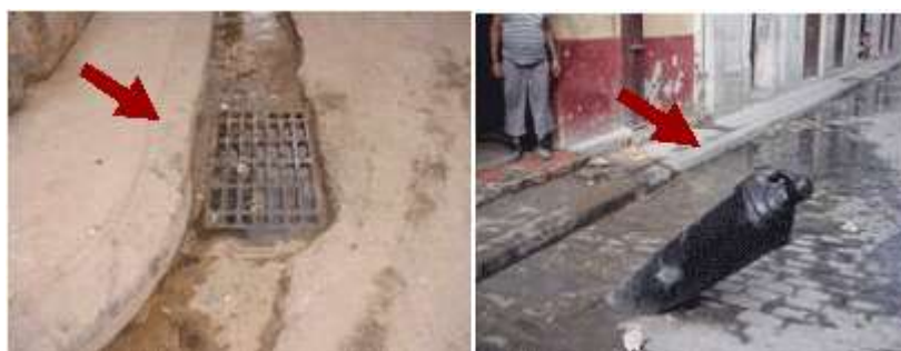
Fig. 7: Vertimiento de residuales líquidos y deficiente estado técnico del alcantarillado
