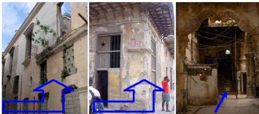
Fig. 8: Deterioro del fondo habitacional
