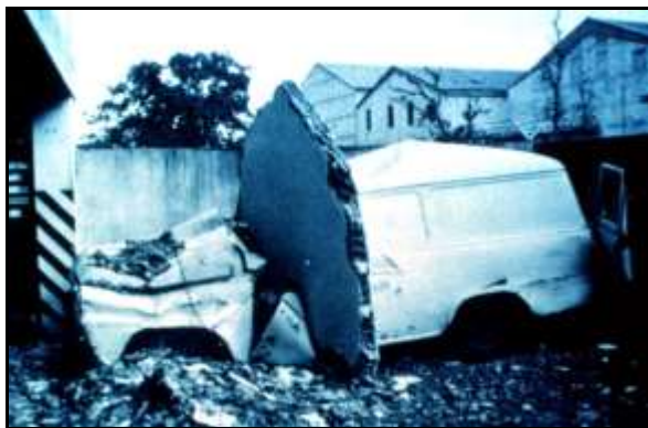
Fig. 6. Caída de componentes arquitectónicos de fachada.
