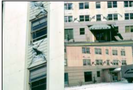
Fig. 2. Agrietamiento de muros de mampostería.
