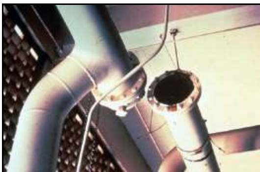
Fig. 8. Rotura de tuberías.
